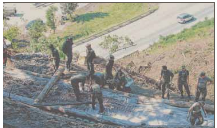
Manche Betroffenen würden ohne die Hilfe des Bundesheers neben den Katastrophen, die sie getroffen haben, auch noch ein finanzielles Desaster erleben. Was kosten 94.000 Arbeitsstunden bei Firmen? Wer verfügt über so spezielle Ausrüstung und Geräte?
